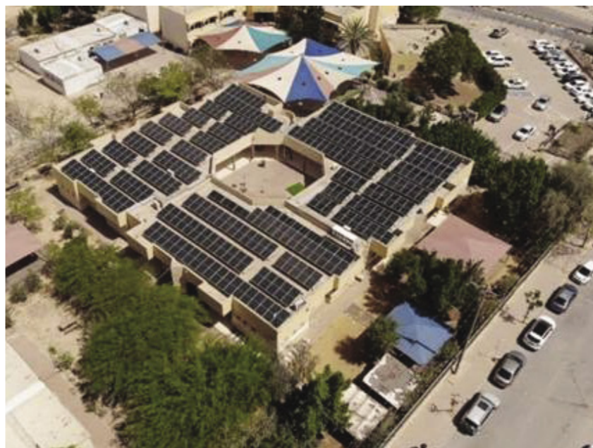
מערכת סולארית על גג בית הספר אבו-וואדי בכסייפה | צילום: ח.י פתרונות חכמים בע"מ, ליגמ פרויקטים סביבתיים בע"מ
